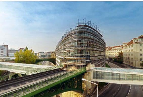
Eine perfekte Symbiose zwischen den historischen Otto Wagner-Bögen und einem Hightech-Bürohaus stellt das Projekt Skyline mit einem hervorragenden Mix aus Büros, Geschäften und Lokalen dar.
