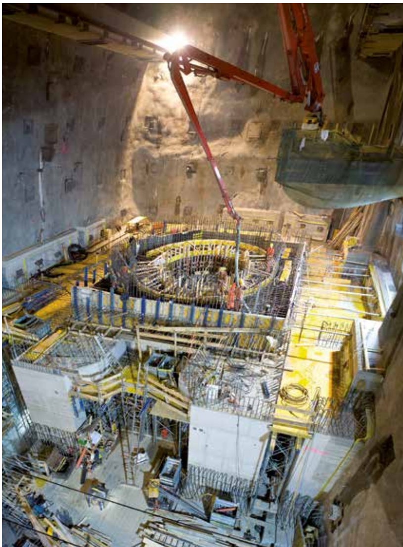
Pumpspeicherkraftwerk Limberg II Für die beiden Maschinensätze mit je 240 MW Leistung wurde eine 62 m lange, 25 m breite und 43 m hohe Kaverne aus dem Berginneren ausgebrochen
