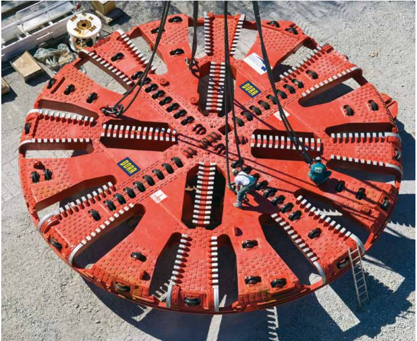
Unterinntalbahn Los H3-4 Präzisionsarbeit beim Montieren des 230 t schweren Schneidrads an die Tunnelvortriebsmaschine
